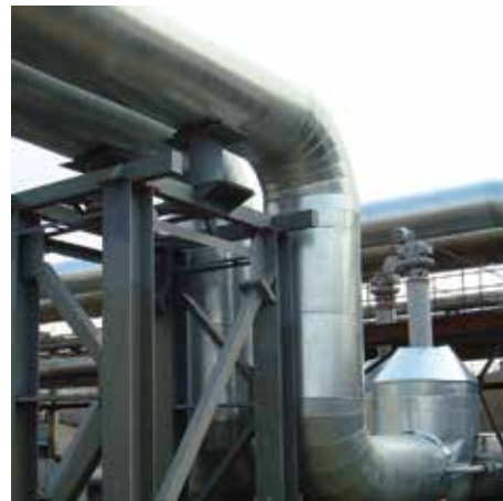
Системы вентиляции, кондиционирования и трубопроводы
