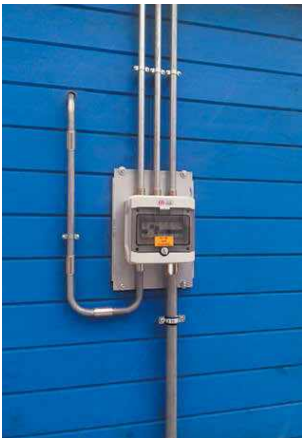
Котеджне містечко в Пущі Водиці. Монтаж кабельної системи згідно вимог ПУЕ 2.1.19 Cottage town in Pushcha Vodytsia. Installation of cable system according to the EIC 2.1.19 requirements
