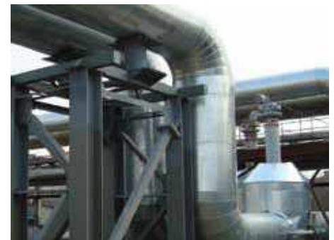
Системи вентиляції, кондиціонування та трубопроводи. Ventilation and air conditioning systems and pipelines.
