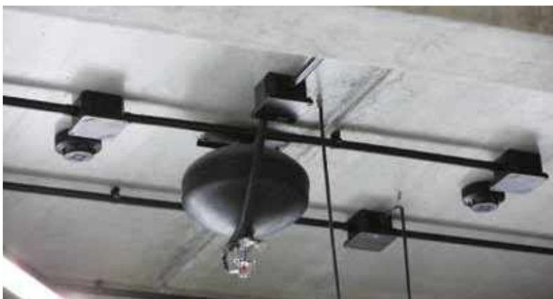
Заправочні станції «Socag». Підключення систем пожежогасіння відповідно до вимог ДСТУ кабельною лінією з вогнестійкістю P90 Socar gas stations. Fire extinguishing systems are connected with P90 cable line in accordance with the requirements of National Standard of Ukraine
