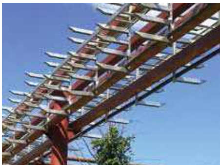
Електричні мережі. Electrical networks.
