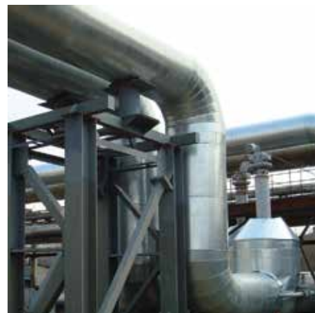
Системы вентиляции, кондиционирования и трубопроводы
