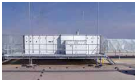
Оборудование на кровле Защита расположенного на кровле оборудования с помощью стержневых молниеприемников
