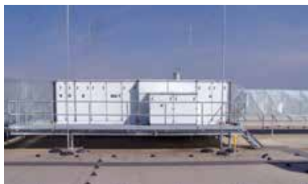
Оборудование на кровле Защита расположенного на кровле оборудования с помощью стержневых молниеприемников
