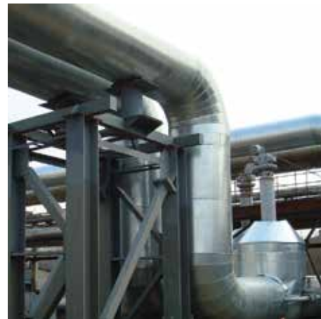
Системы вентиляции, кондиционирования и трубопроводы
