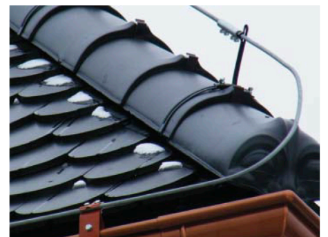
Токоотвод, смонтированный на коньке кровли с помощью конькового держателя
