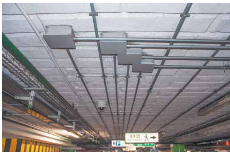
Паркинг ТРЦ «Ocean Plaza». Кабеленесущая система с защитой IP67
